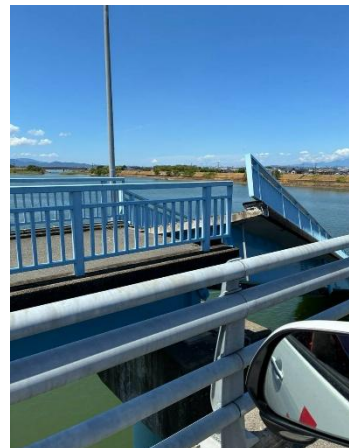
地震で橋の一部が 落下した状態
